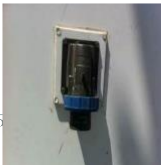
RED INERTE TOMA EXTERIOR
